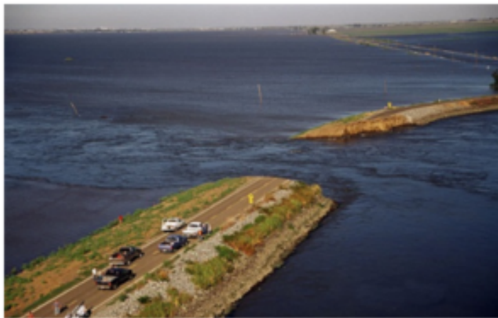
Rupture de digue par surverse ©Université de Stanford
