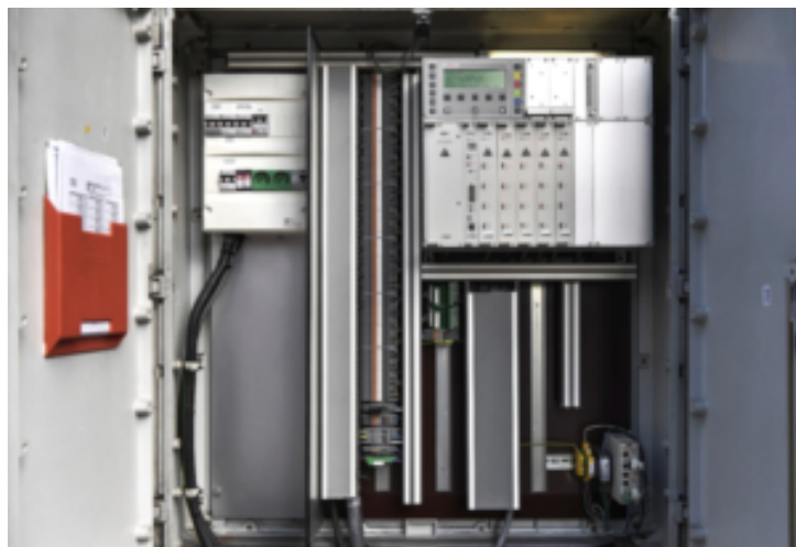
Vue de l'intérieur d'une armoire de feux à un carrefour (avec ordinateur local connecté à la centrale) ©Bruxelles Mobilité
