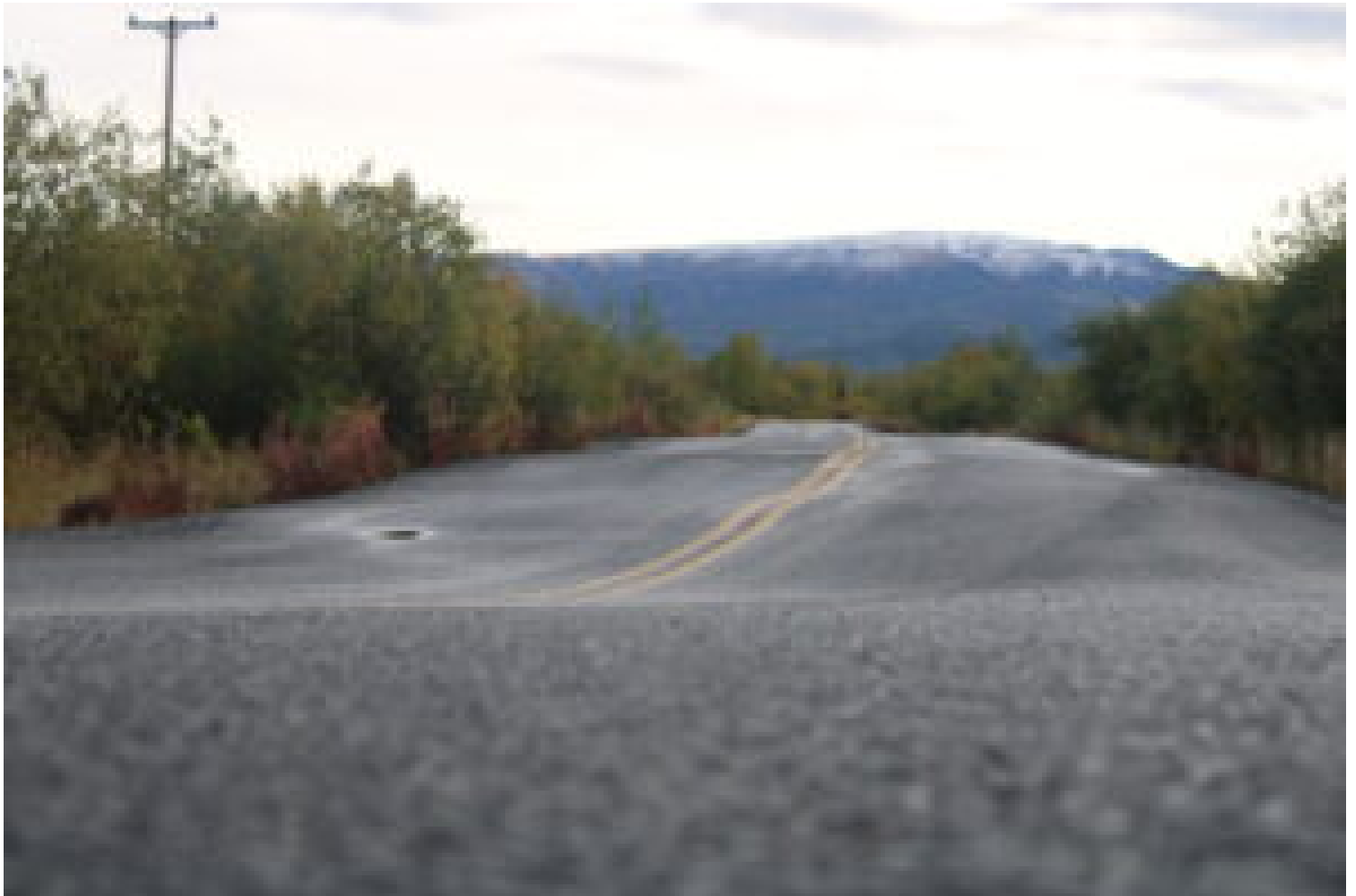
Route bosselée et dégradée à cause du dégel du pergélisol © Sophie Opfergelt / UCLouvain
