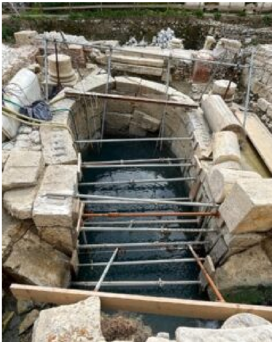
Le bassin avant d'être vidé de son eau en vue des fouilles © scavi San Casciano dei Bagni
