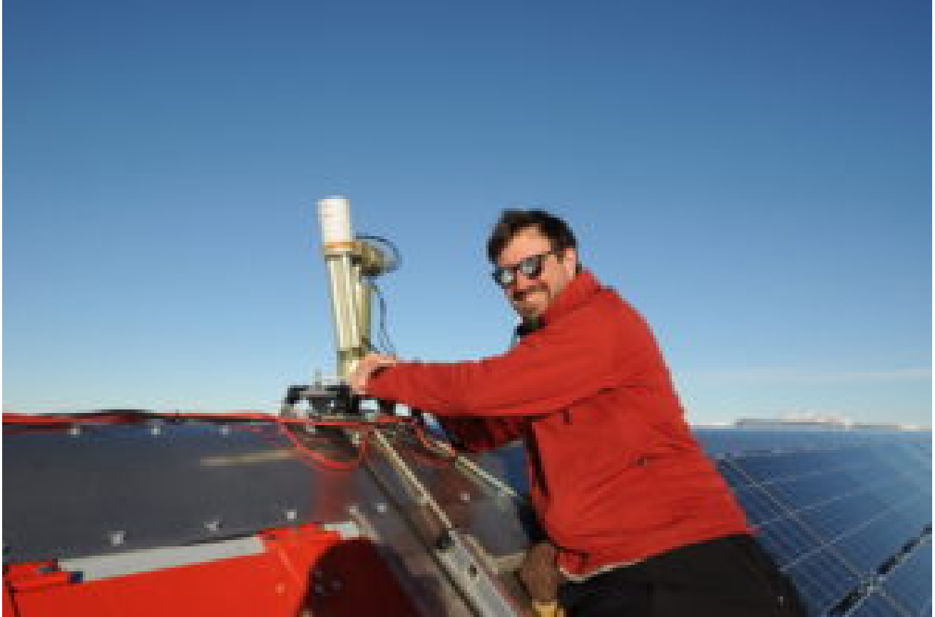
Alexis Merlaud, de l'IASB, installe un photomètre solaire sur le toit de la station © Henri Robert / IPF
