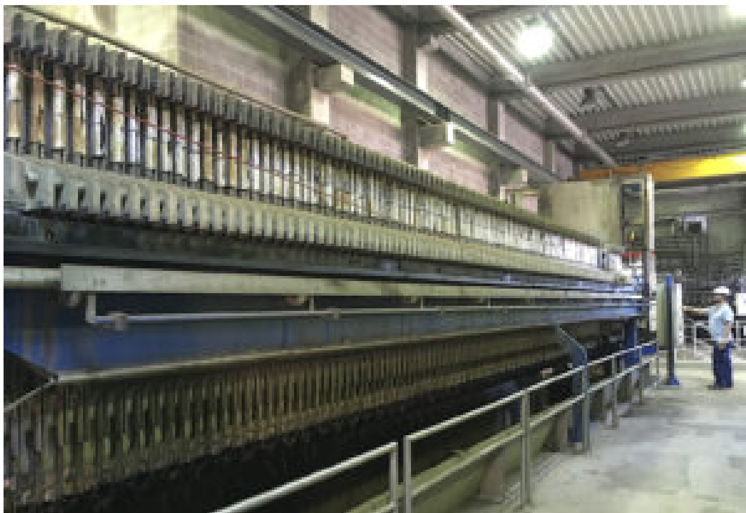
Station d'épuration de Bruxelles © Région Bruxelles-Capitale
