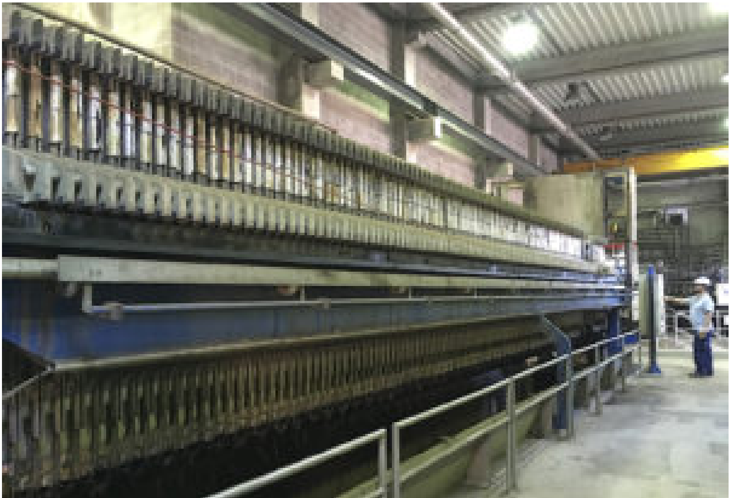
Station d'épuration de Bruxelles © Région Bruxelles-Capitale
