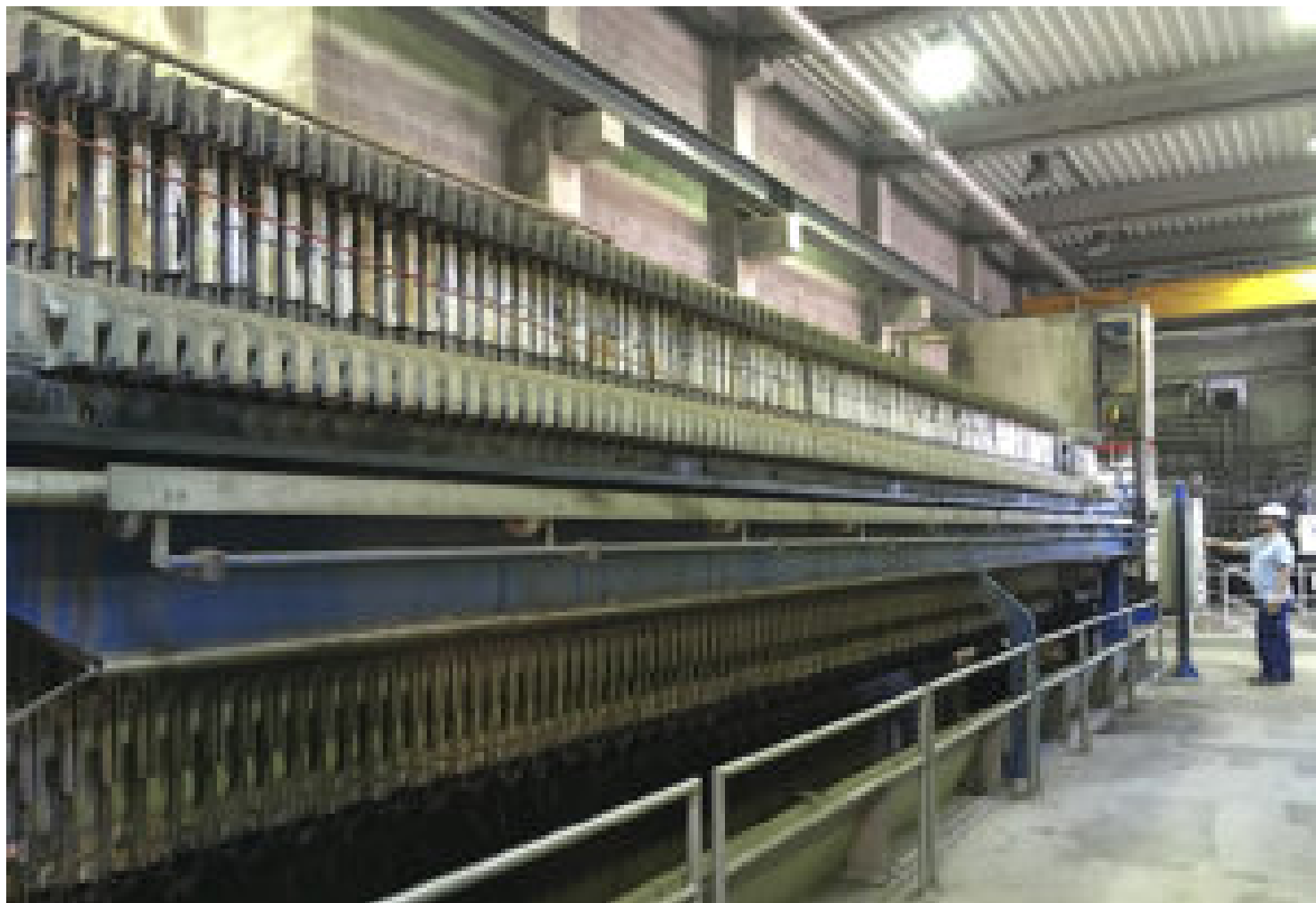
Station d'épuration de Bruxelles © Région Bruxelles-Capitale
