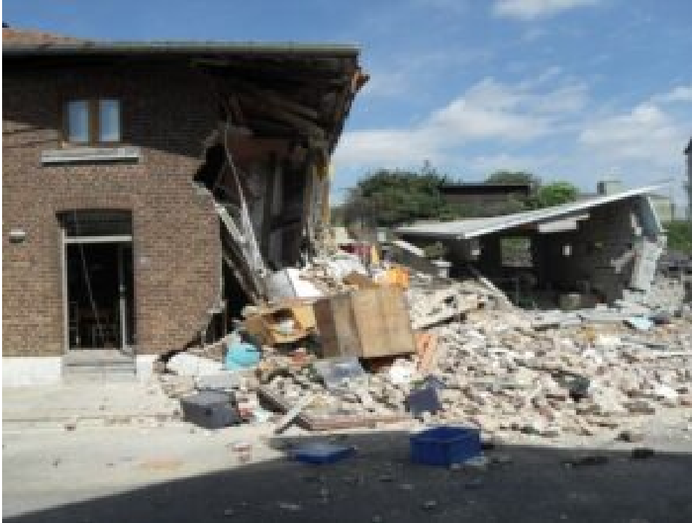
Effondrement d'une maison à Wasseigne (Liège) après un effondrement souterrain © SPW
