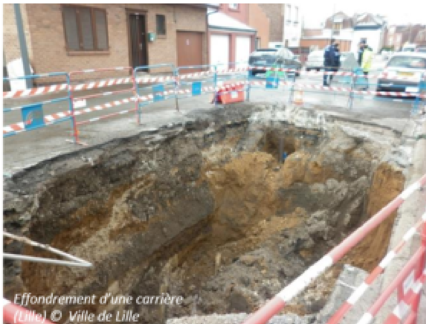
Cratère dans chaussée de Lille suite à l'effondrement d'une ancienne carrière souterraine © Ville de Lille
