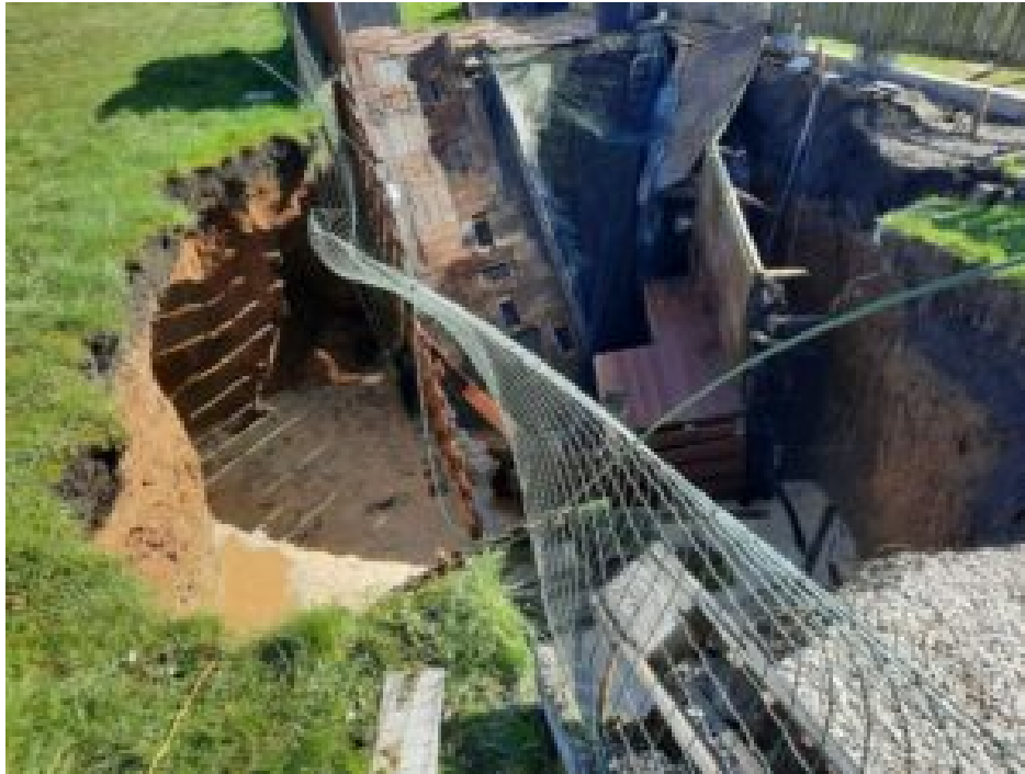
Cratère dans un jardin privé à Quaregnon ( Hainaut) suite à un effondrement souterrain © SPW
