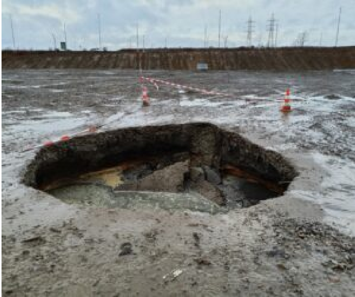
Cratère sur un chantier à Vottem (Liège) suite à un effondrement du sous-sol
